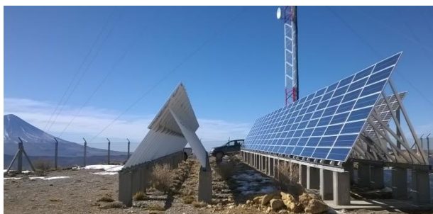
Y.P.F. Indra – Cara Cura, Mendoza Sistema para Repetidora de Telecomunicaciones
