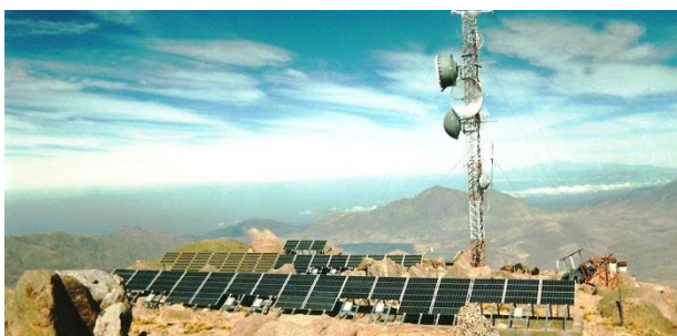
TELECOM – El Negrito, Tucumán Sistema para Repetidora de Telecomunicaciones
